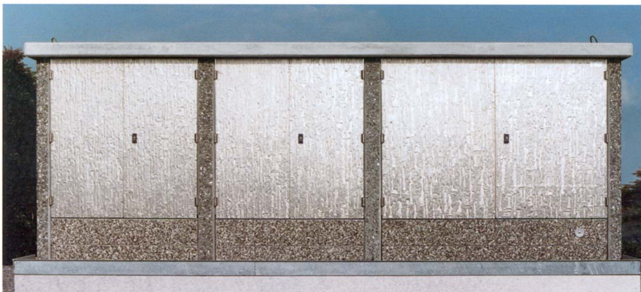
Le poste formant station de pompage avec trois compartiments séparés.
