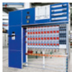
Distribution basse tension
