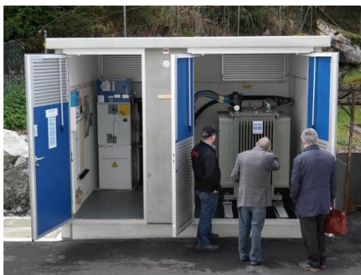
Cabina di trasformazione Borner Tipo Midi 3036 + 30
